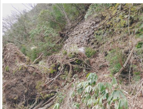
崩落上部の状況
