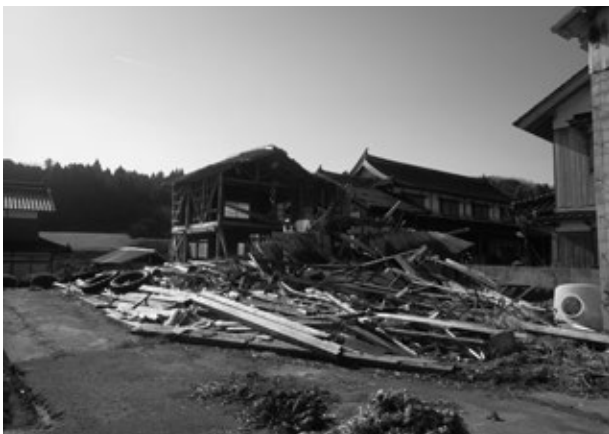
所有者不存在建物管理人制度により除却する危険空家（八反田）
