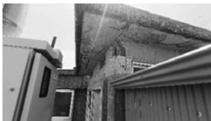
▲軒天の劣化の様子
