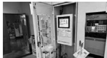
中央監視装置
