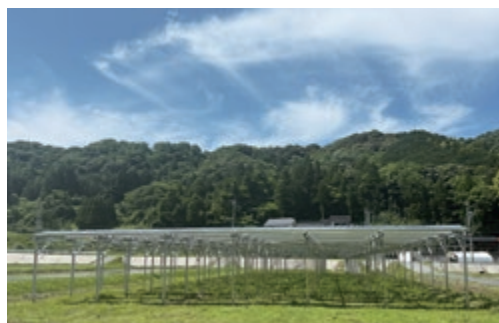
完成した大杉地区の太陽光発電設備
