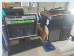
中央監視装置
