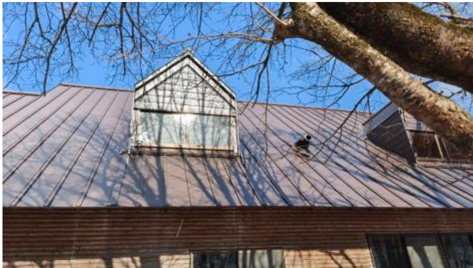
屋根破損状況
