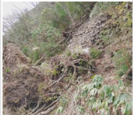
崩落上部の状況
