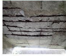
床板の鉄筋露出（広範囲）
