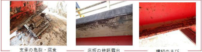
支承の亀裂・腐食
