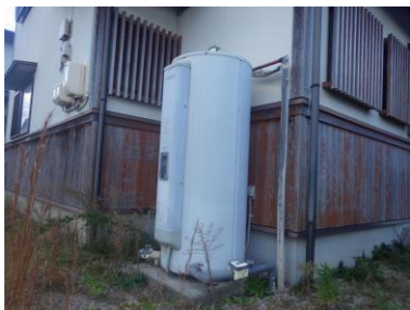
取替を行う榎下団地給湯器
