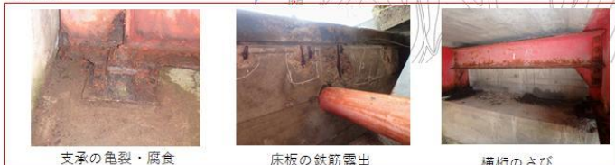
支承の亀裂・腐食
