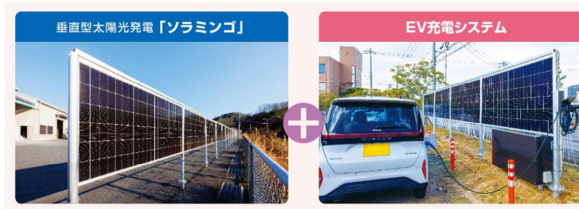
図40. 垂直型太陽光発電×EV充電
