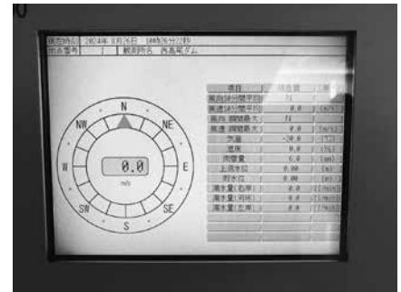
西高尾ダム気象観測装置整備の更新
