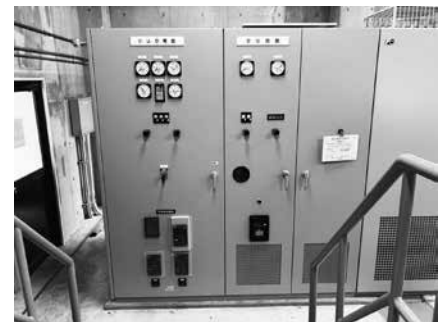
西高尾揚水機場電気設備の更新
