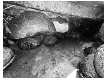
上光好地区暗渠水路の閉塞状況
