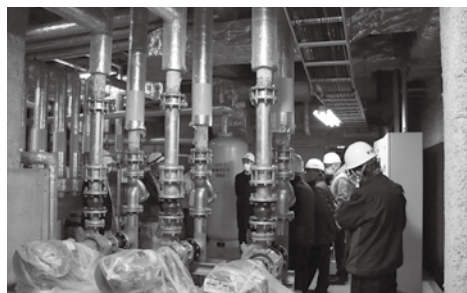
地下空調設備
