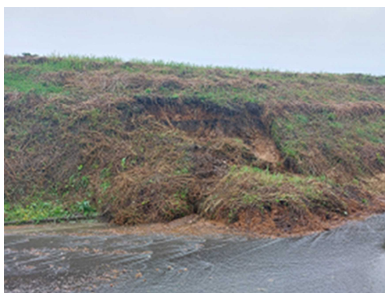
町道別所中線の法面崩壊状況
