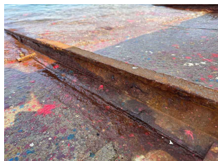
レール劣化状況
