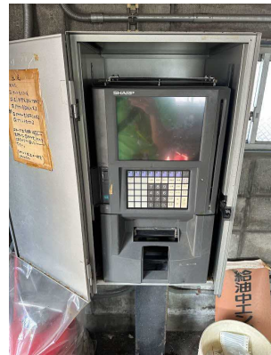
給油設備のアイランド プリンター液晶不具合
