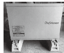
住宅に設置された蓄電池
