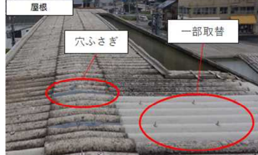
劣化程度：5（スレート交換前） 状態：スレートが反り亀裂が入っている箇所について、スレートの交換や穴をふさぐなどの対応をしている
