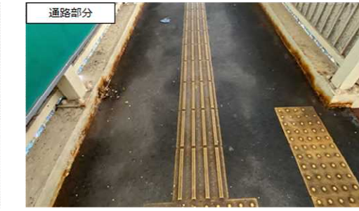
劣化程度：4 状態：欄木に錆が発生し腐食が進行し、部材欠損
