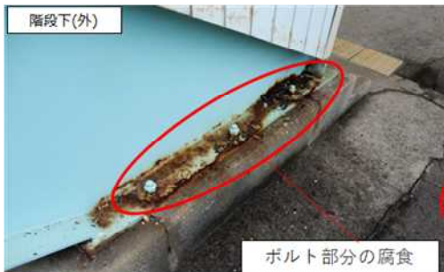
劣化程度：4 状態：全体的に錆が発生し、構造の支えとなる部分やボルト部分に腐食が進んでいる
