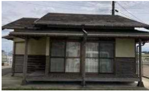
浦安団地集会所 屋根の劣化、破損状況
