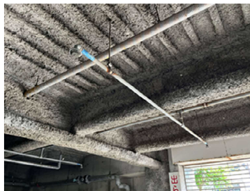
1階駐車場天井に設置している消火剤の管とフォームヘッド
