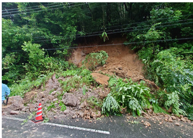
法面崩壊した町道鋤上野線
