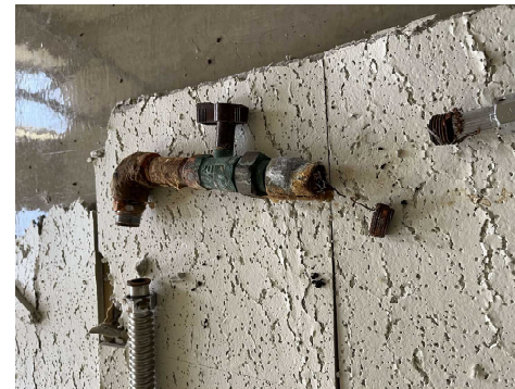
漏水部分の部品 全面的にサビが 目立つ状況 全館の配管も同 様と考えられる
