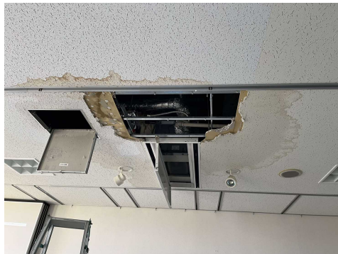
空調冷却水漏水 により、天井が 落下
