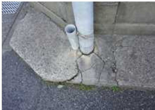
〈地面のヒビ割れ〉
