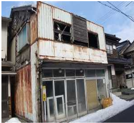
略式代執行で除却する危険空き家
