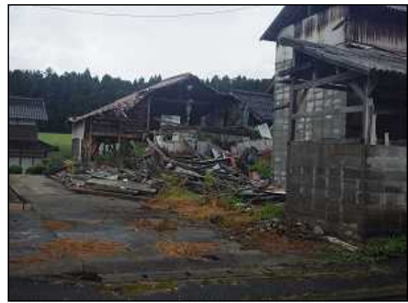
所有者・相続人がいない危険空き家
