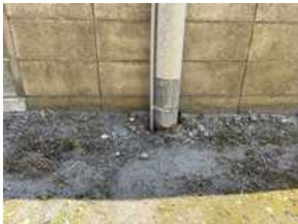
〈錆により付け根が断裂〉
