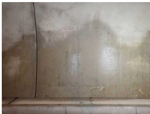
側壁に生じた浸出（にじみ）
