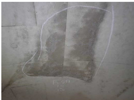
アーチに生じた浸出（にじみ）
