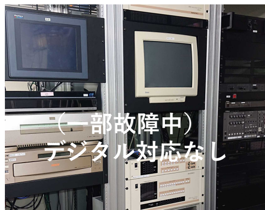
シアタールーム 機械設備
