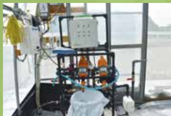
自動かん水設備
