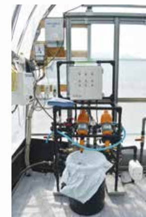
自動かん水設備
