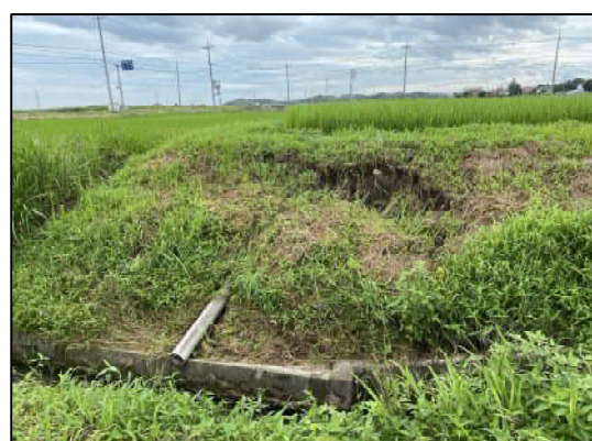
農地(田)法面の崩落(美好)
