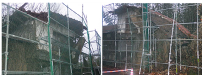
老朽化や大雨等で建物の一部が崩落（令和6年1月）
