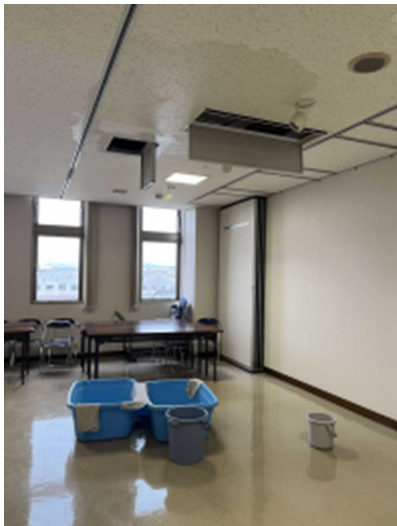
▲3/21に天井裏が浸水、水もれ
