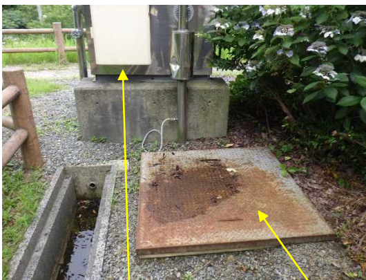
白色が貯水タンク、鉄蓋部分が滅菌装置
