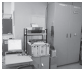
東伯地区の中央監視システム
