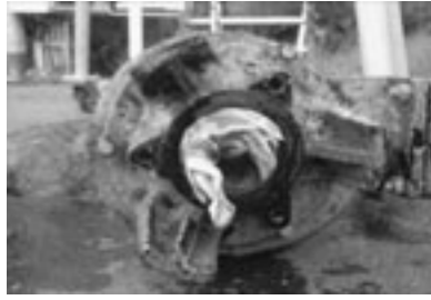
▲タオルなどの異物が詰まり、汚水が流れなくなったポンプ
